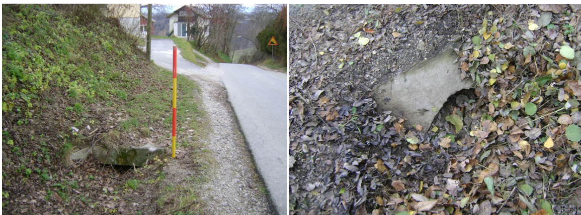
Slika 10: Neustrezno urejeno odvodnjavanje.
