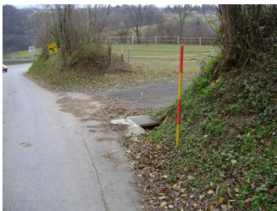
Slika 16: Neustrezno urejeno odvodnjavanje.
